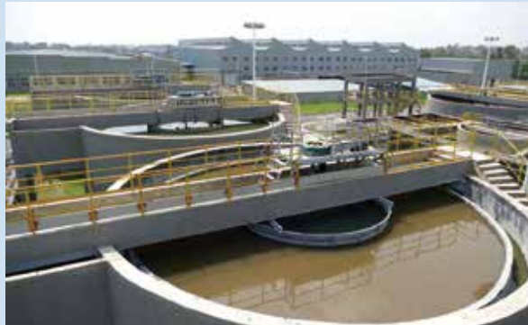
哈瓦萨工业园零液体排放设施
